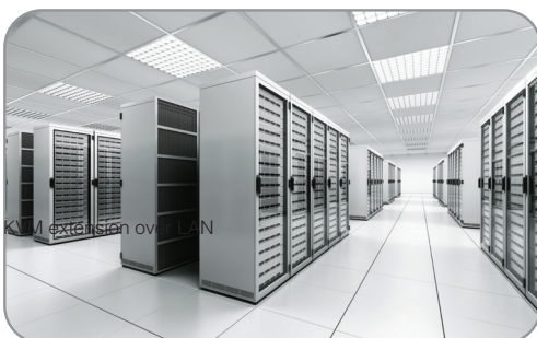
Salle des serveurs
